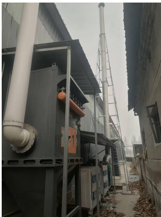
图 4-1 废气处理设施图片
