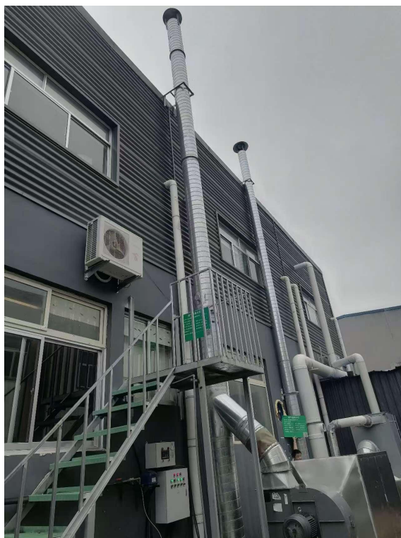
图 4-1 废气处理设施图片
