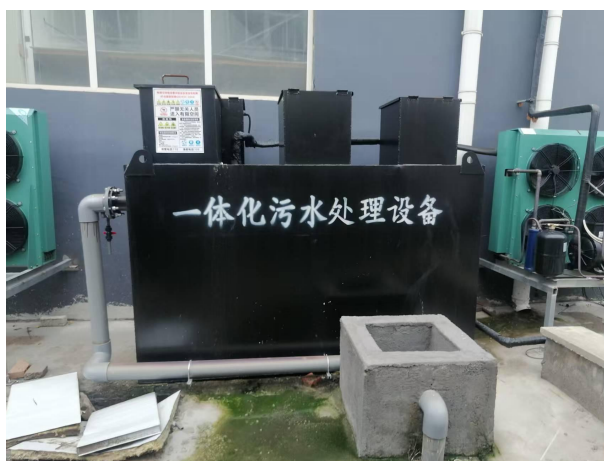
图 4-2 废水处理设施图片
