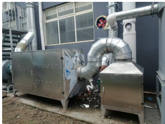
除湿+活性炭吸附装置
