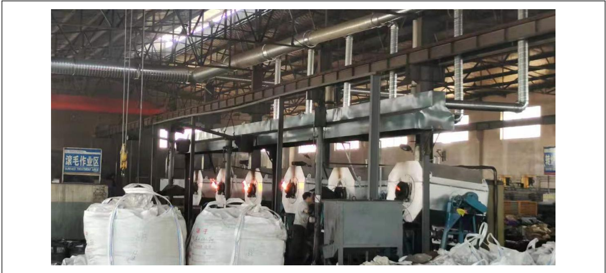
图 4-1 项目废气收集、处理设施及排气筒
