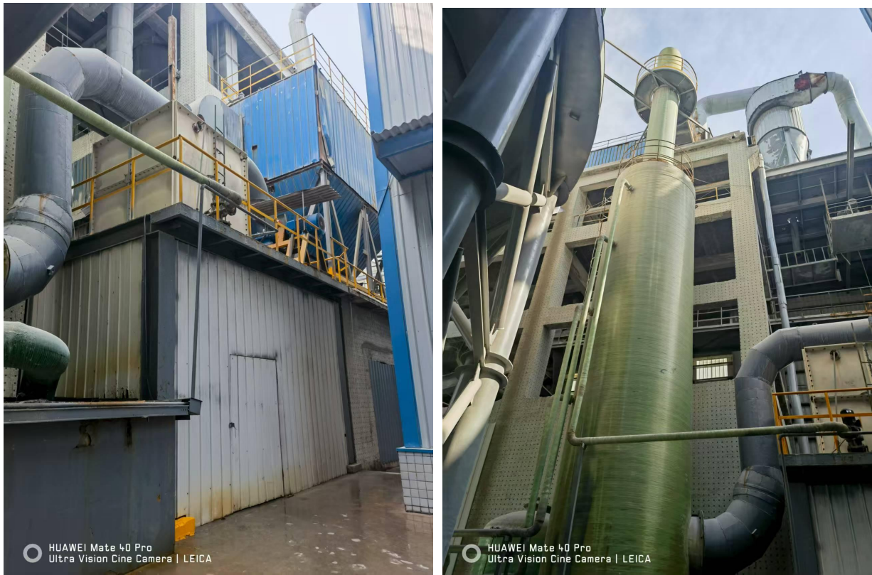
图 5 DA001 排气筒（环保设施：袋式除尘+湿法脱硫）
