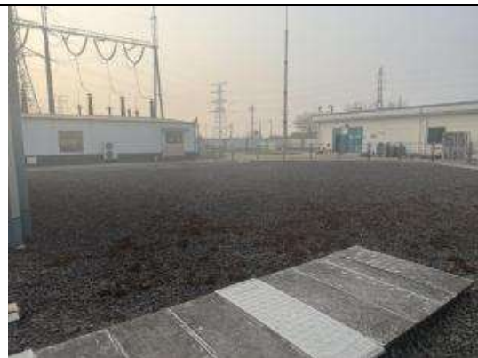
3号主变预留位置
