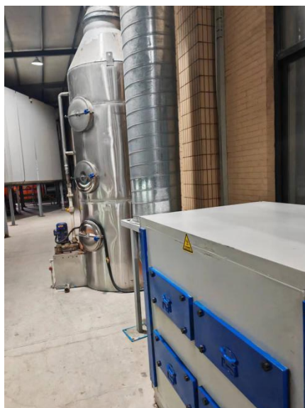
水喷淋+活性炭处理装置
