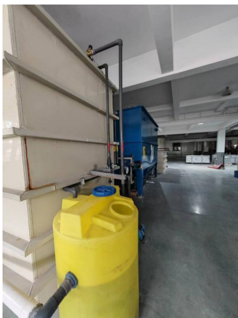
生产废水处理设备
