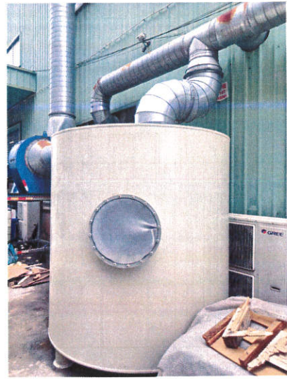
废气处理设施（活性炭）
