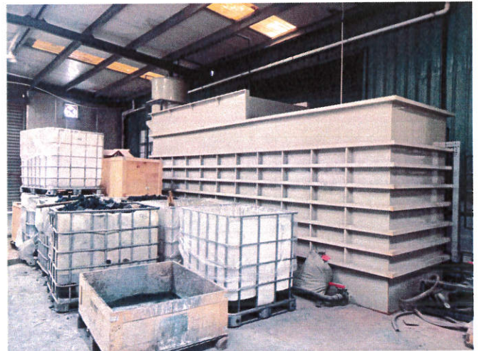
废水处理设施
