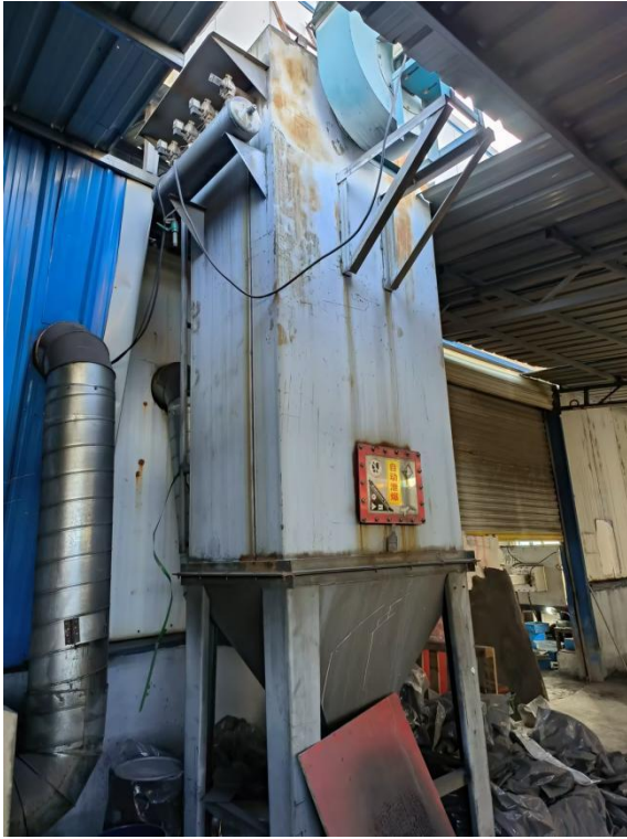
混合废气处理设施+排气筒
