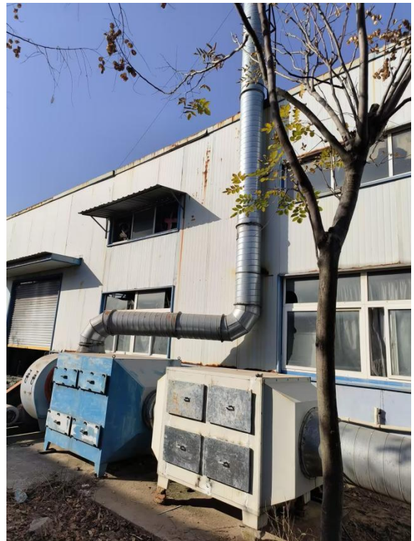
2#脱胶、注塑废气处理设施+排气筒
