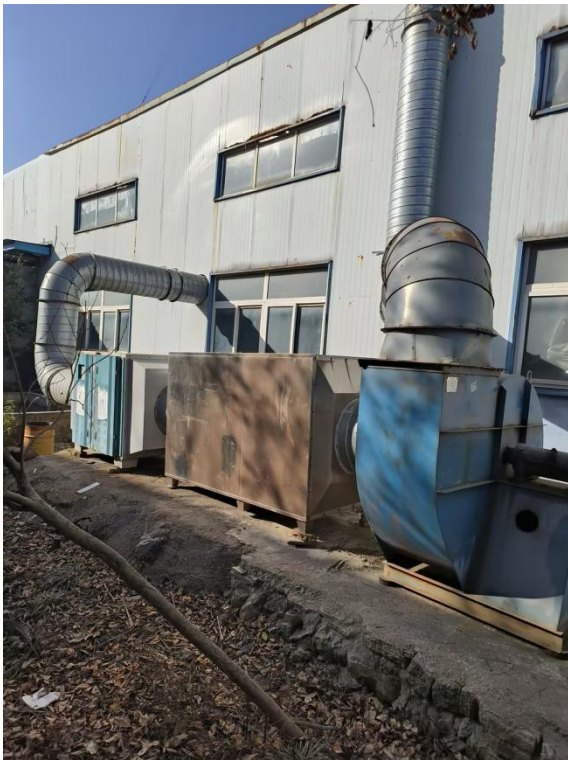
1#脱胶、注塑废气处理设施+排气筒
