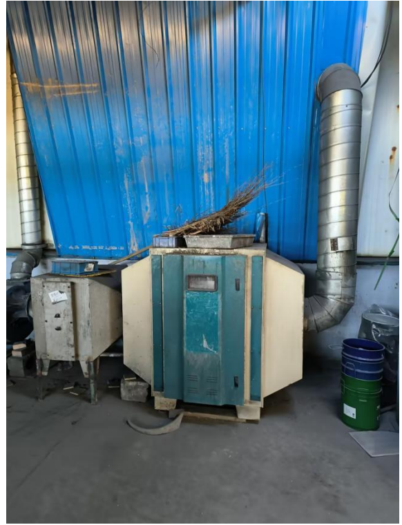
加热废气处理设施+排气筒
