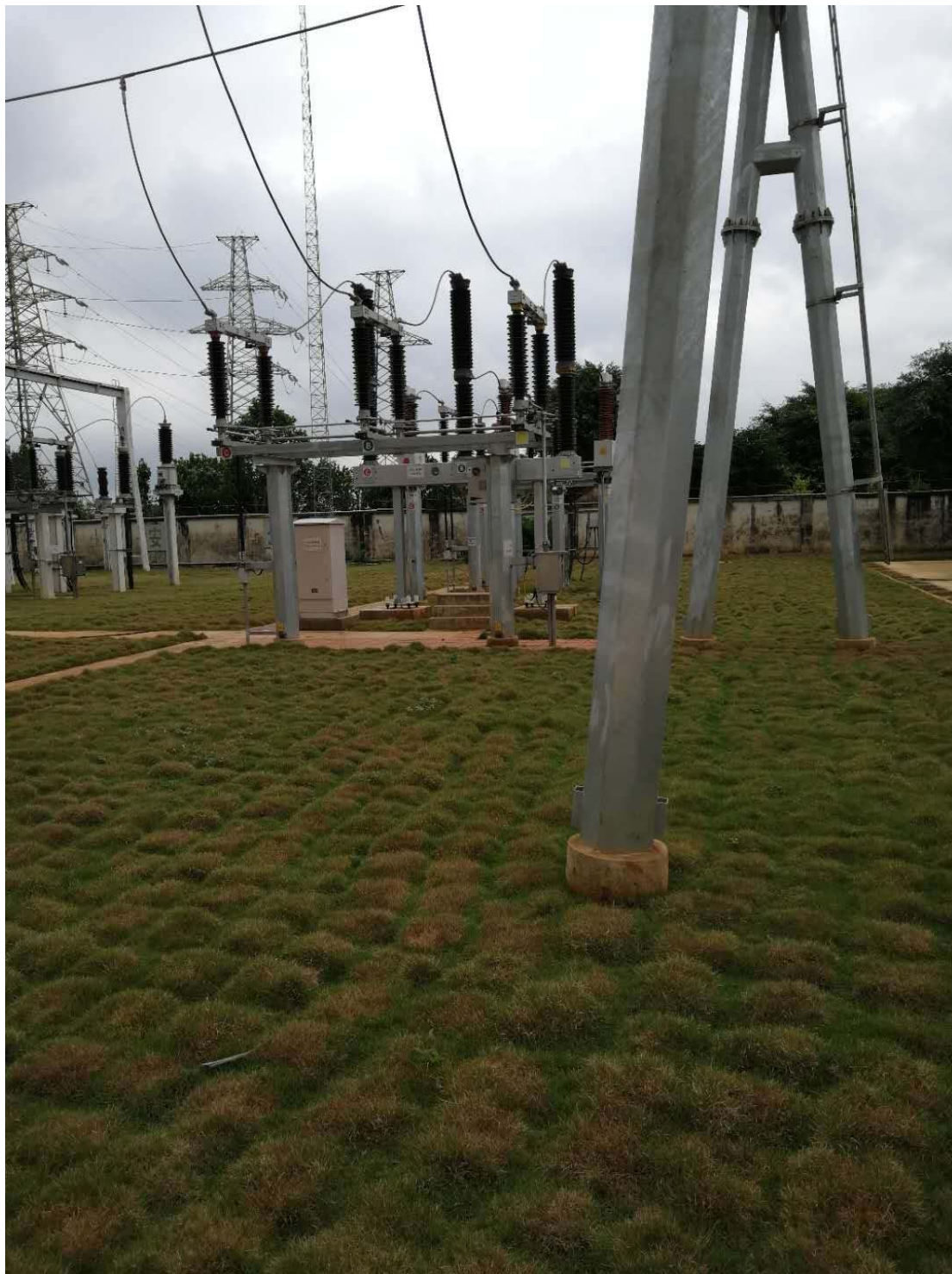
变电站扩建区绿化（2018.4）
